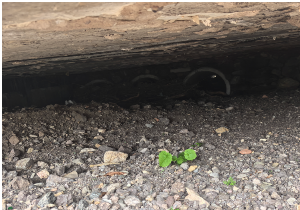
桥下混凝土管堵塞淤积严重
